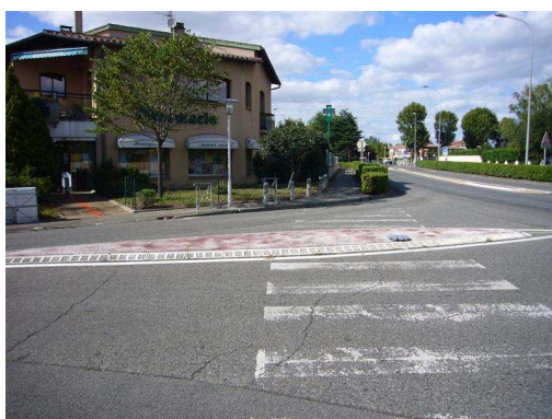
Traversée rue des Cèdres, marquage au sol effacé, traversée îlot central impossible, absence de bateau
